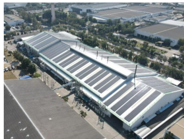
タイの工場に設置された太陽光パネル（ECT）
