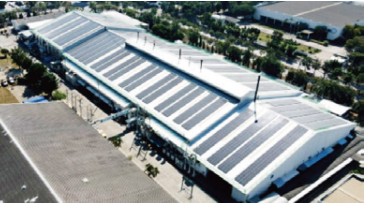
タイECTの工場に設置された太陽光パネル
