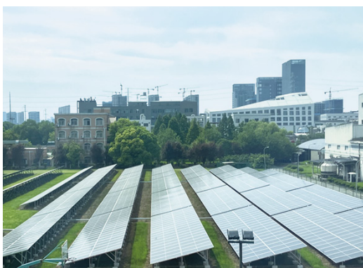
中国の製造工場に設置された太陽光発電設備
